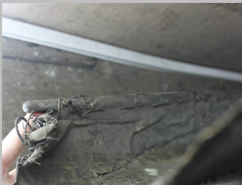
Figura 120: Pormenor da trave metálica na bainha da margem inferior da pintura.
