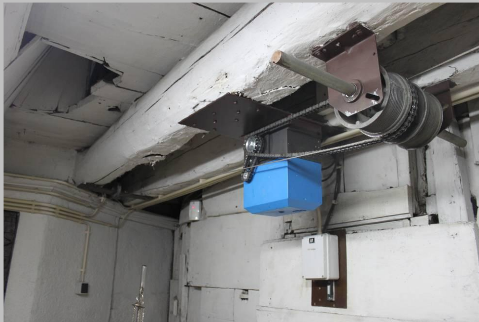
Figura 99: Pormenor do mecanismo que movimenta a pintura.
