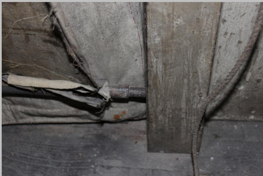
Figura 116: Pormenor da trave metálica existente na bainha da margem inferior da pintura.
