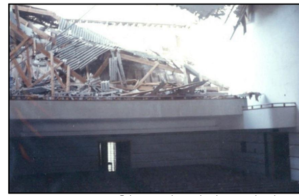
Sala principal após desabamento da cobertura. Lusomundo, 1993
