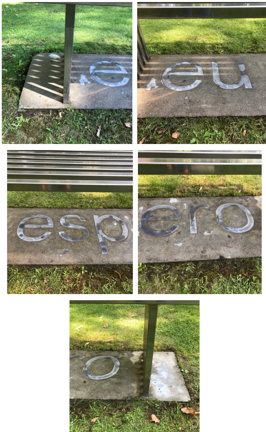
Figura 278- Figura 282- Pormenores da laje de betão e letras de chumbo após a limpeza da escultura Eu Espero (©Carlota Carvalho)
