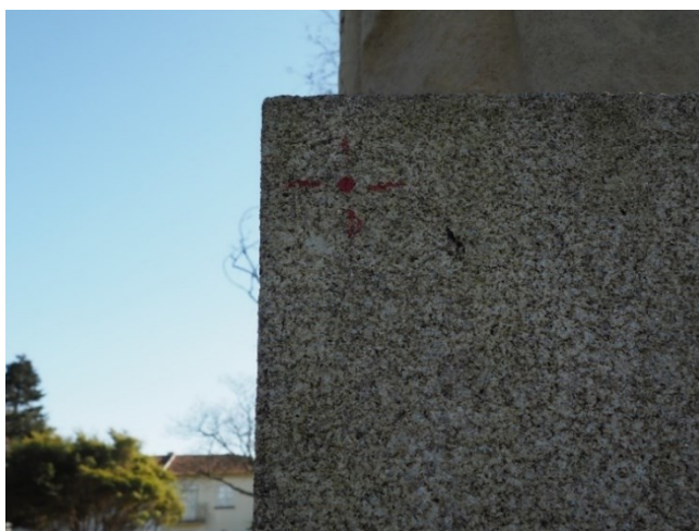
Figura 22. pormenor da base em granito da vista lateral esquerda da escultura Afonso de Albuquerque - Vandalismo: aplicação intencional de tintas (©Carlota Carvalho)
