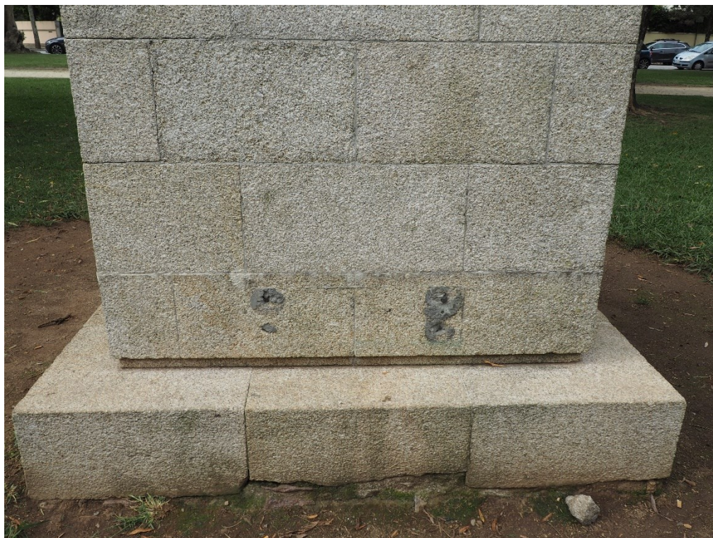
Figura 53. Pormenor da vista do tardo da base de granito (zona onde antes se encontrava a placa de bronze com a identificação da obra- Vandalismo: Roubo) (©Carlota Carvalho)
