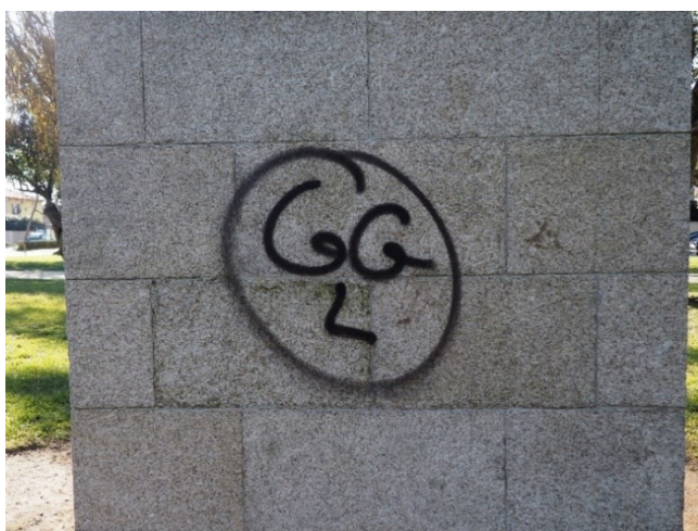
Figura 23. pormenor da base em granito da vista do tardo da escultura Afonso de Albuquerque - Vandalismo: Graffiti (©Carlota Carvalho)
