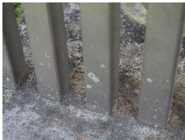
Figura 11. Pormenor da Presença de Colonização Biológica e Manchas de Corrosão na Laje de Betão (©Carlota Carvalho)
