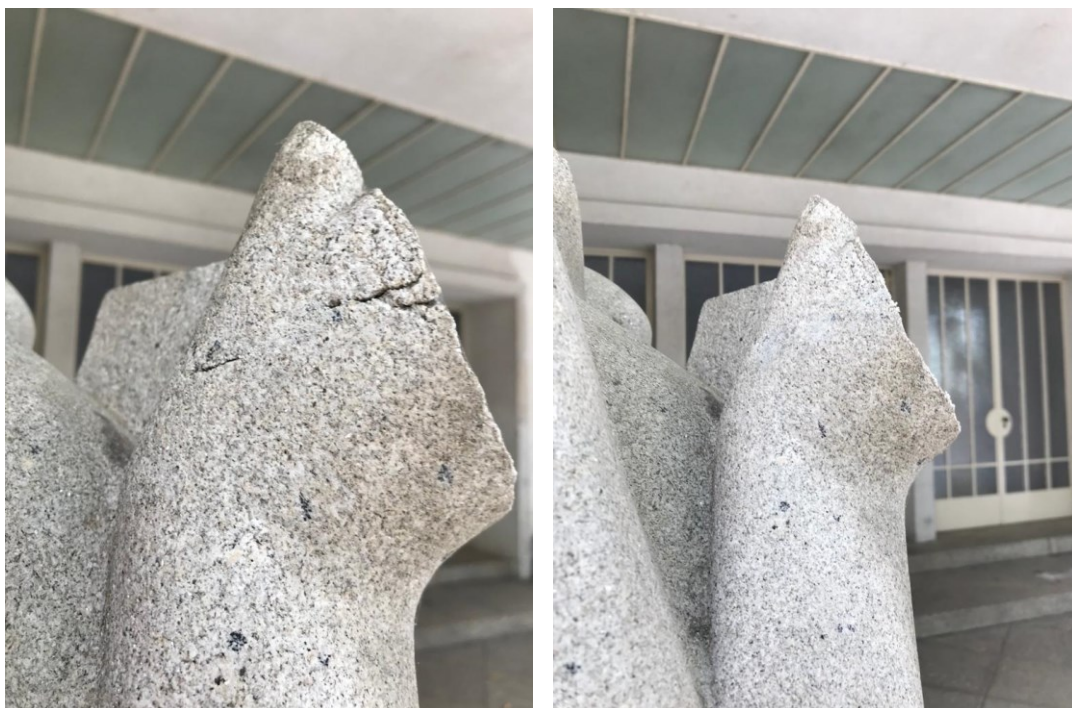
Figura 194 e Figura 195. Reintegração da fissura existente na mão em falta (vista lateral esquerda) (©Carlota Carvalho)
