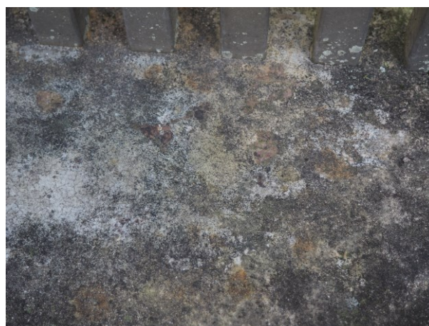
Figura 12. Manchas de Corrosão na Laje de Betão (©Carlota Carvalho)
