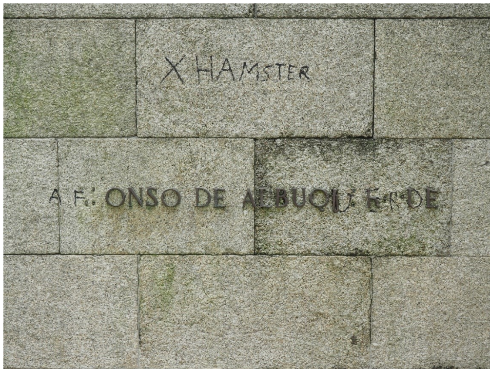
Figura 51. Pormenor da base em granito (vista frontal)- Vandalismo: Graffiti , Tentativa de Roubo e Roubo (©Carlota Carvalho)
