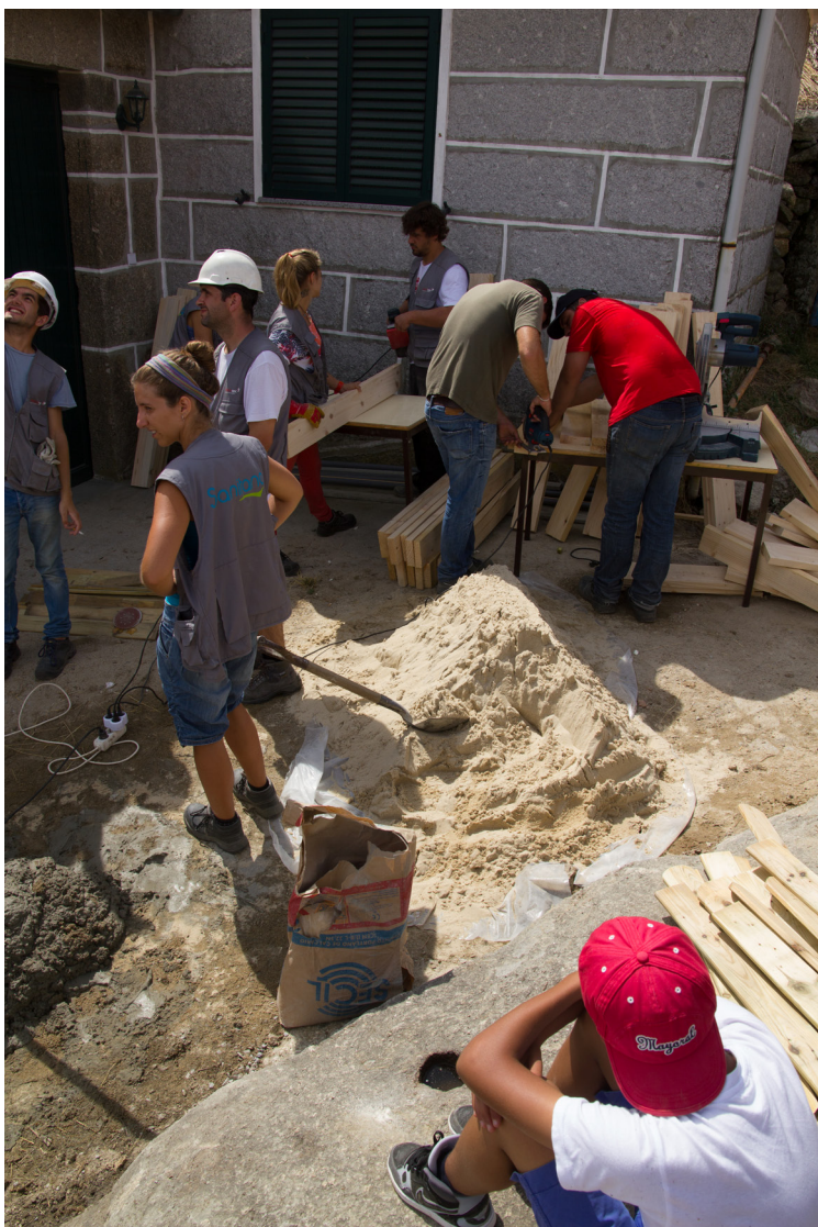
Figura 114 – Realização dos elementos de madeira que irão ser a divisória do hall e da cozinha/sala (Fonte:Cláudia, 2014)
