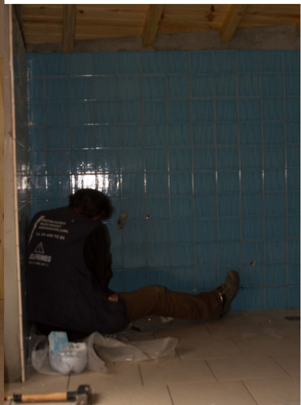
Figura 118 – Instalação da eletricidade (Fonte:Cláudia, 2014)
