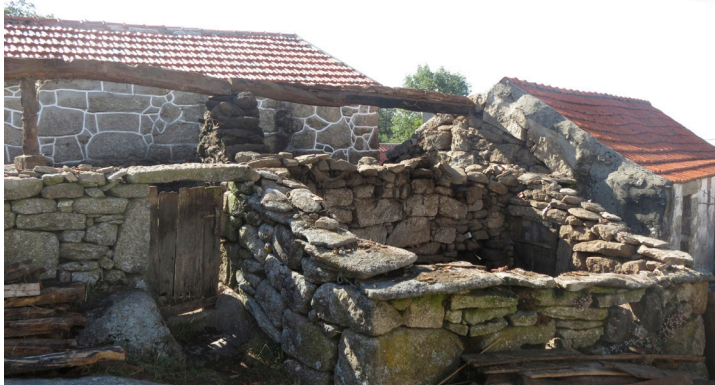
Figura 70 – Casa da Cristina sem cobertura (Fonte:Autor, 2014)
