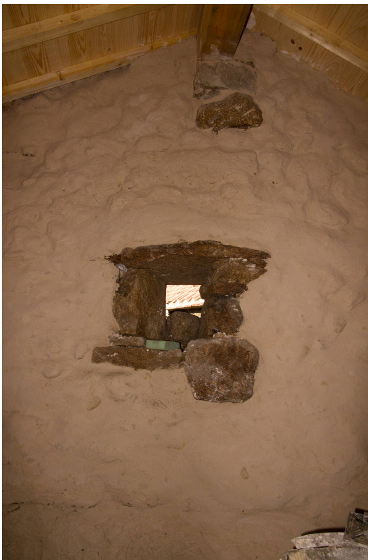
Figura 97 – Argamassa na parede do quarto (Fonte:Cláudia, 2014)
