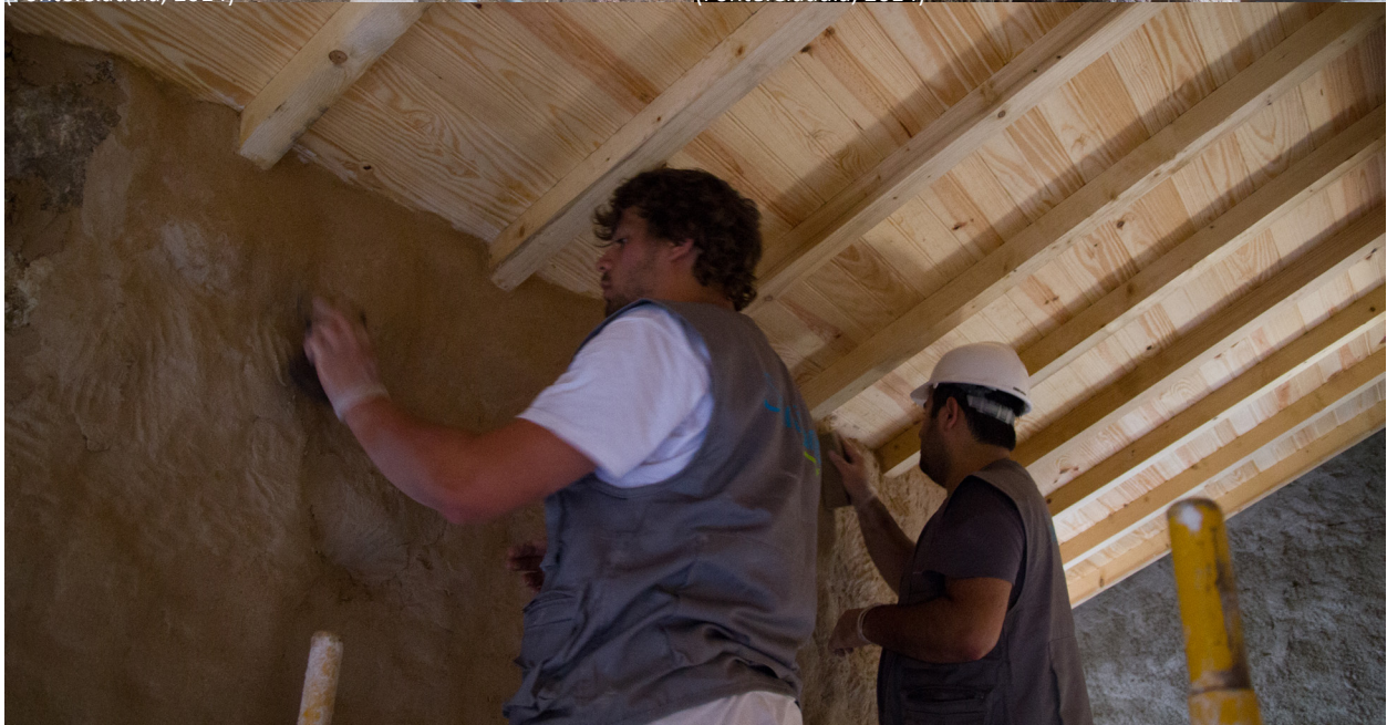
Figura 109 – Remate da argamassa na parede divisória da cozinha com a casa de banho (Fonte:Cláudia, 2014)
