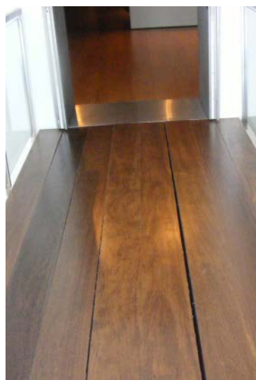
Figura 18 - Passadiço suspenso no 2º piso. Ligaçao da Casa do cabido às edificações anexas. Guardas de protecção lateral com 1m e altura não cumprindo legislação em vigor.
