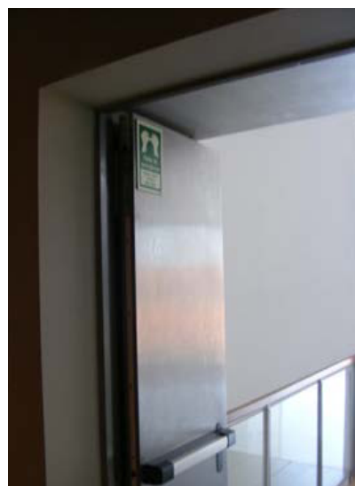
Figura 19 - Perspectiva da antiga Casa do Cabido sobre o passadiço suspenso no segundo piso. A altimetria usada nas protecções laterais deixa antever risco de segurança na circulação.
