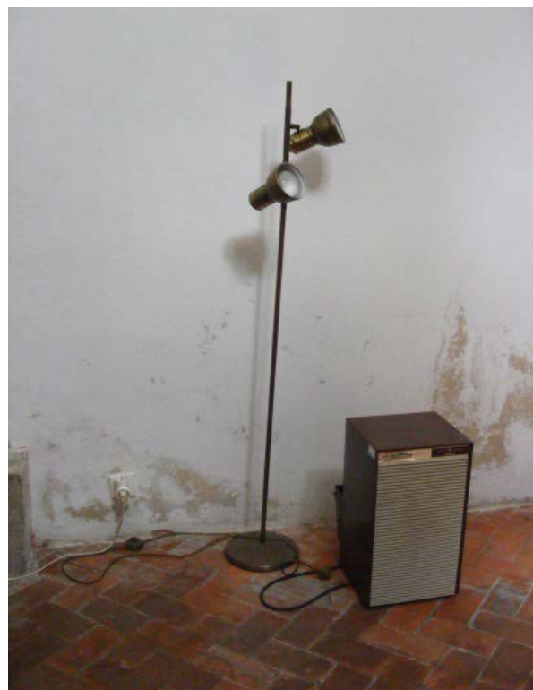
Figura 13 - Pavimento interior de espaço do Percurso Monumental Pavimento cerâmico e parede com eflorescências salinas.
