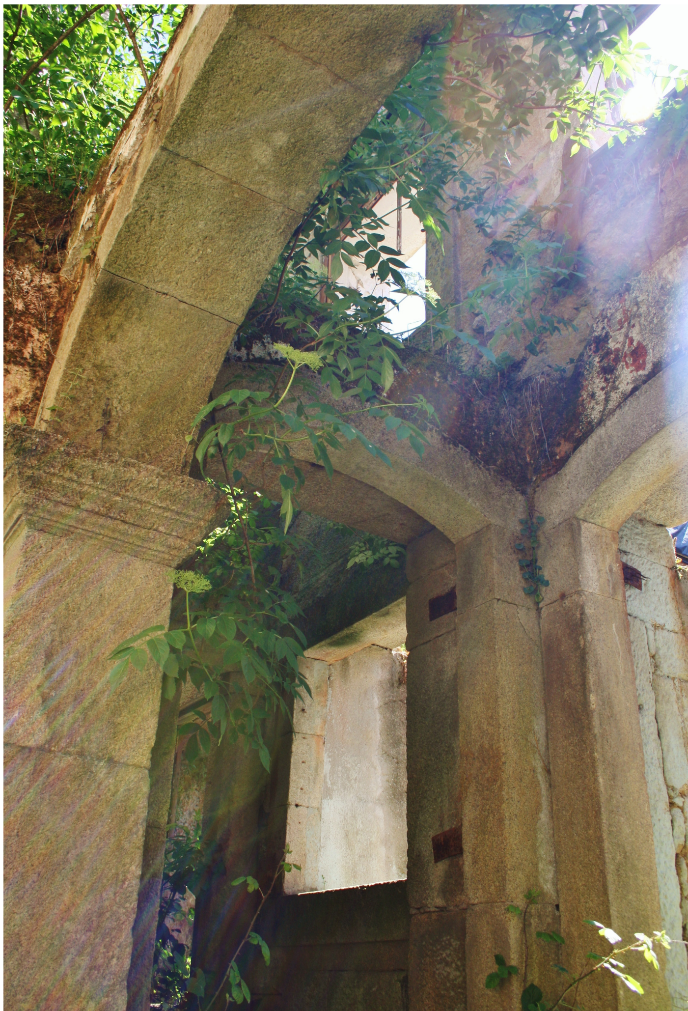
FIGURA 5 Casa das Bocas em ruína Fonte: autora
