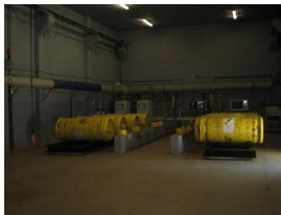
Figura 2.50 – Armazenagem dos Tambores de Cloro
