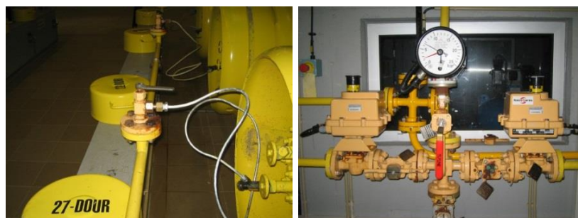
Figura 2.51 – Ligação dos tambores ao “changeover”
