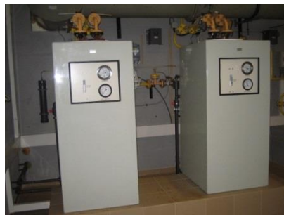
Figura 2.53 – Evaporadores de cloro líquido
