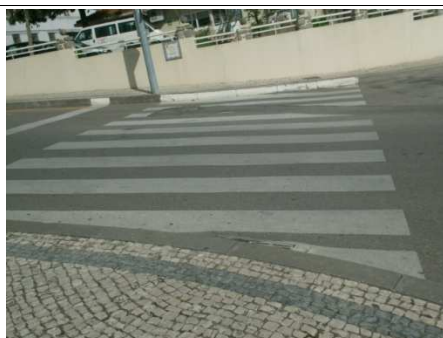
Passeios sem rampa, com lancil muito elevado.
