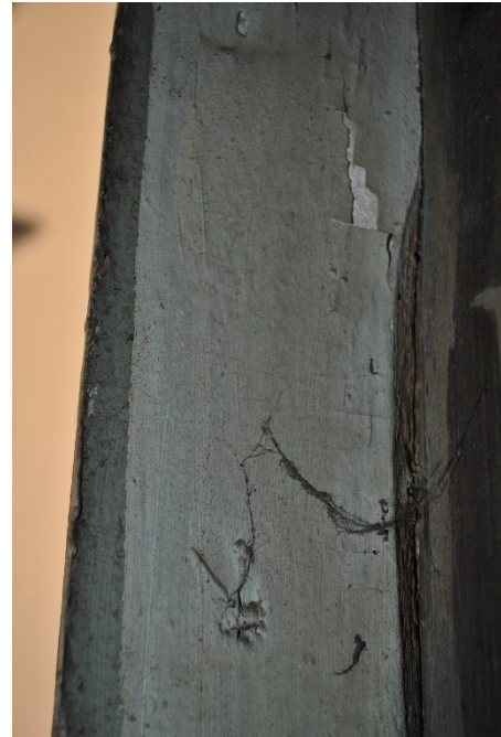
Figura 17 – Fissuras e destacamentos na policromia interior do oratório
