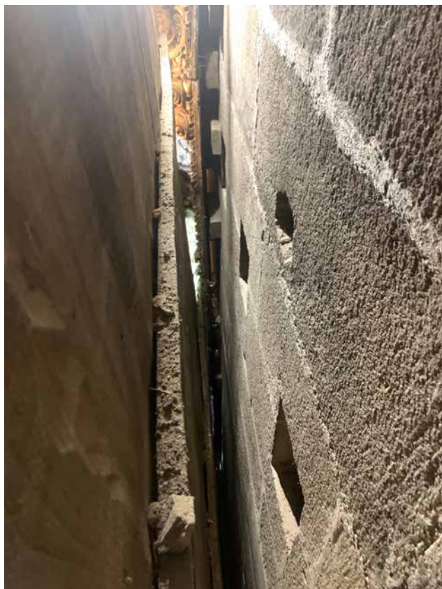
Detalhe do verso da pintura evidenciando a proximidade à parede de alvenaria e a ausência de elementos de ancoragem (2021, Centro de Conservação e Restauro da Universidade Católica Portuguesa©, fotografia de equipa CCR).
