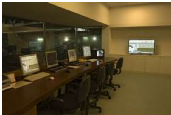
Figura I.14 – Sala de comando e controlo da CVO
