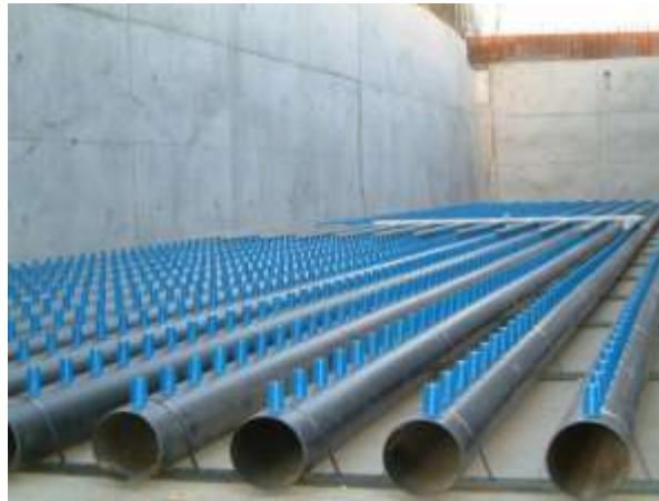
Figura I.12 – Colocação do sistema de arejamento (tubagem e spigots ) nos túneis, fase de construção.
