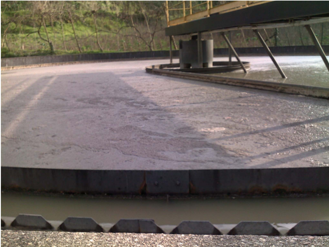
Figura 1 - Decantador Secundário da Etar do Areinho
