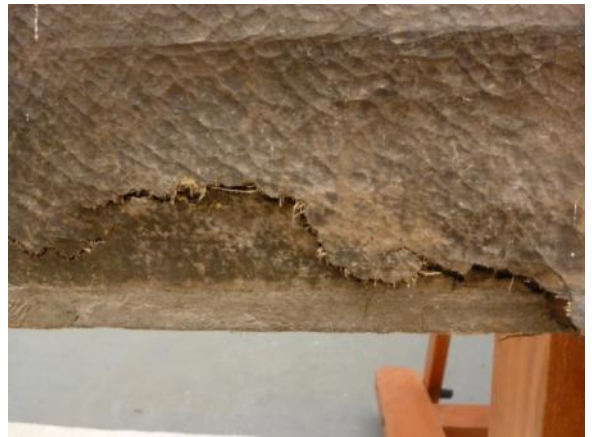
Fig. 62 Fotografia da obra antes do tratamento - Pormenor
