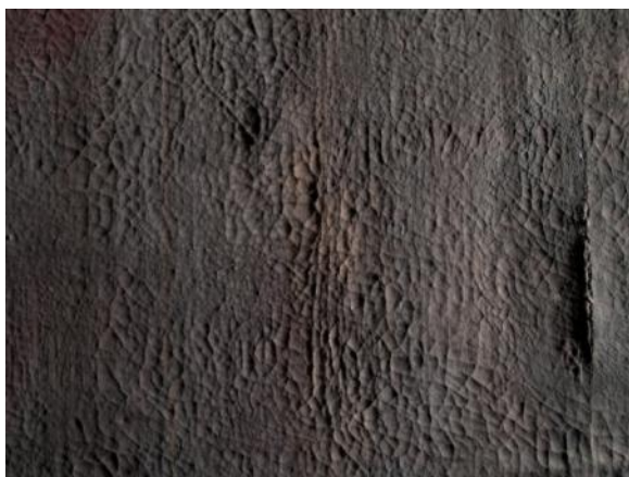
Fig. 91 Fotografia da obra antes do tratamento com luz rasante direita - Pormenor
