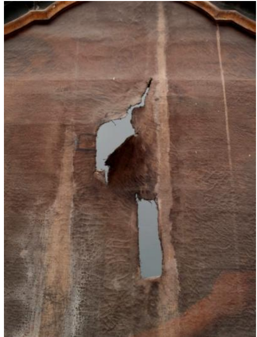
Fig. 46 Fotografia da obra antes do tratamento - Pormenor
