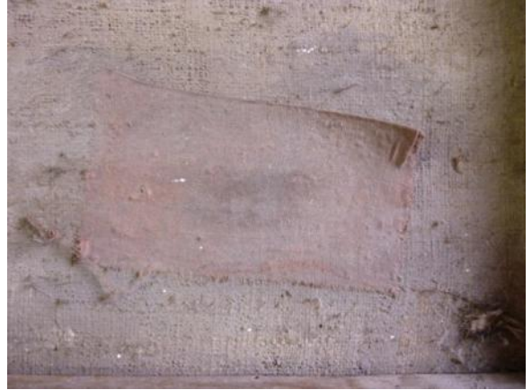
Fig. 74 Fotografia da obra antes do tratamento - Pormenor
