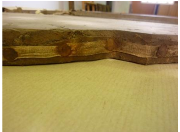
Fig. 82 Fotografia da obra antes do tratamento - Pormenor
