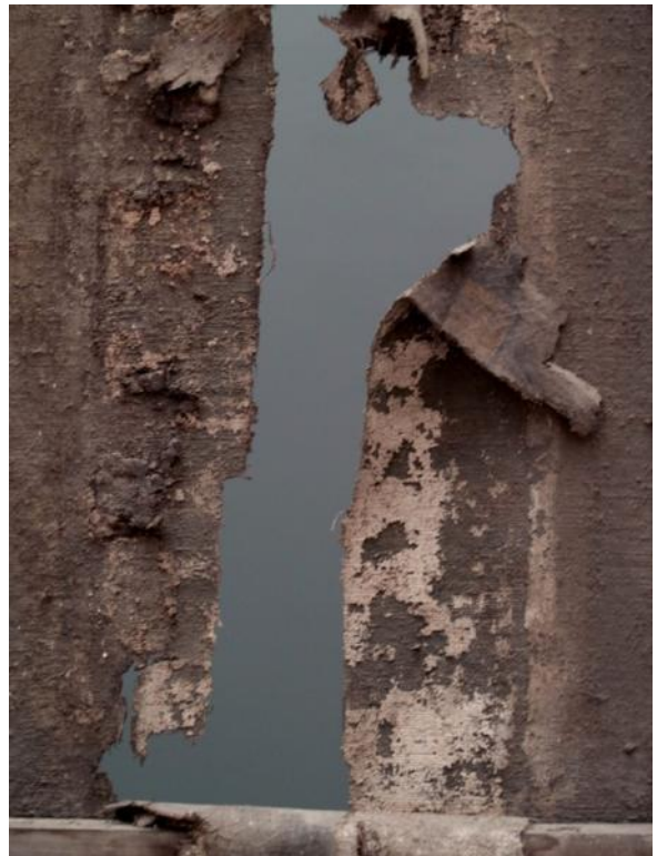
Fig. 66 Fotografia da obra antes do tratamento - Pormenor
