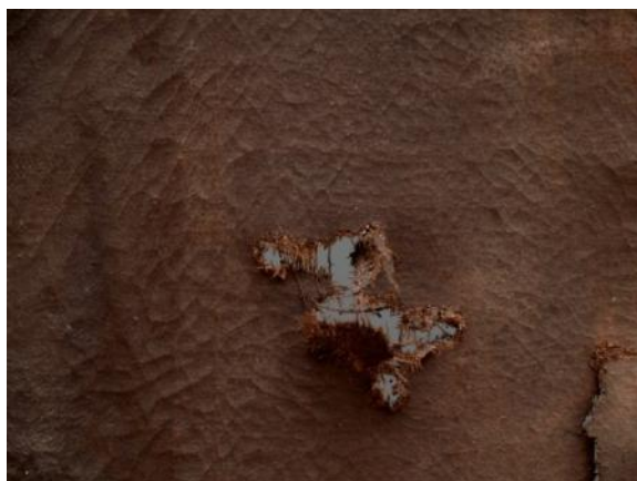
Fig. 54 Fotografia da obra antes do tratamento - Pormenor
