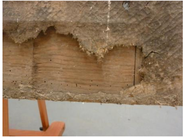
Fig. 60 Fotografia da obra antes do tratamento - Pormenor
