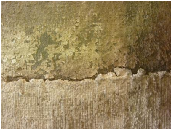
Fig. 79 Fotografia da obra antes do tratamento - Pormenor
