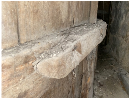
Figura 46: Acumulação de detritos e poeiras Autoria: Soraia Martins
