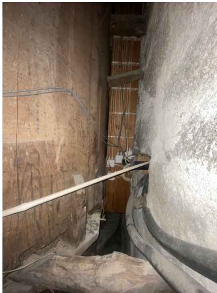
Figura 49: Elemento de madeira adicionado para instalação do sistema elétrico Autoria: Soraia Martins
