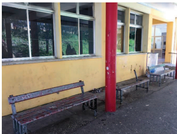
Figura 5: Degradação do espaço escolar
