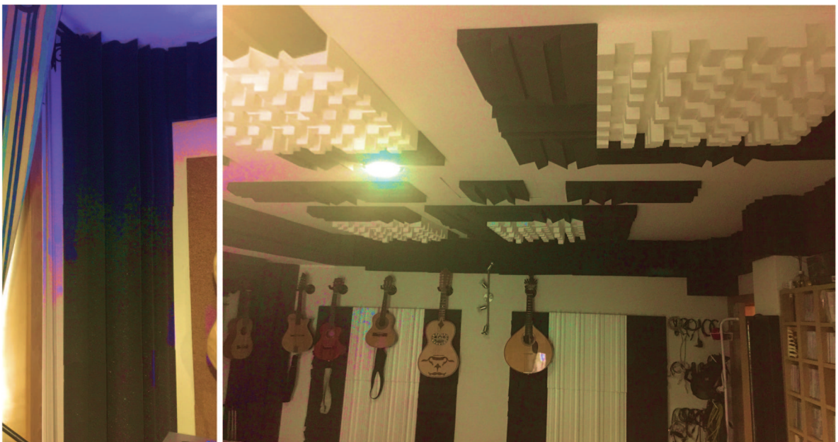
Figura 3 - Pormenores do tratamento acústico da sala
