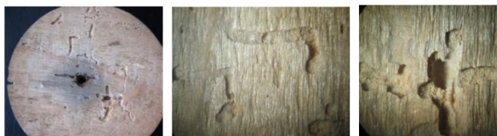
Figs. 28 a 30 – Deterioração da peça A, galerias com serrim devido a anobídeo.
