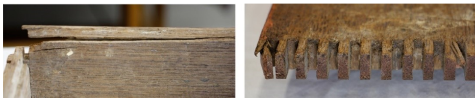
Fig. 51 Elementos de madeira partidos e amassados (26/11/2016).
