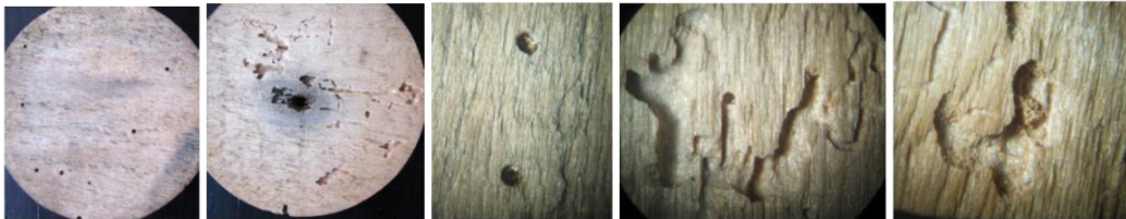
Figs. 42 a 46 – Deterioração da peça B, orifícios de saída e galerias com serrim devido a anóbídeo. Também se vêem manchas escuras devido a fungo.
