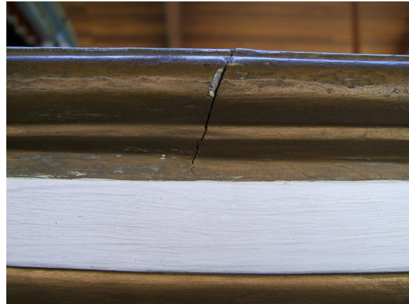
Estado de conservação: assemblagens debilitadas.
