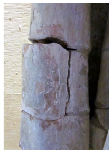
Figura 4 – Pormenor de fractura de parte de um taceiro.
