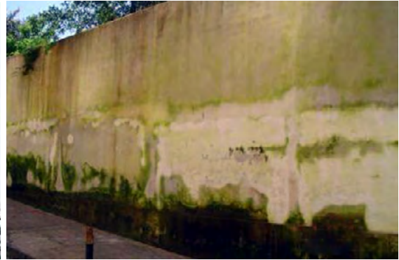
Figura 10 – Rebocos de um muro de uma casa, à Rua de São Bento, em Olinda. Com um mês de execução do restauro já apresentava graves infestações de fungos e proliferação de algas, antes mesmo de ser pintado. Fonte: CECI/nov2007
