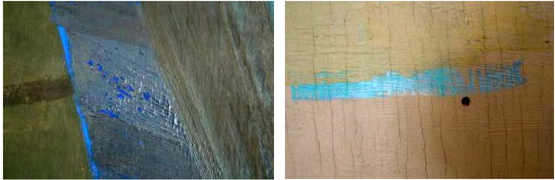
Figura 19 – Ilustração de descolamentos pontuais antes da consolidação.
