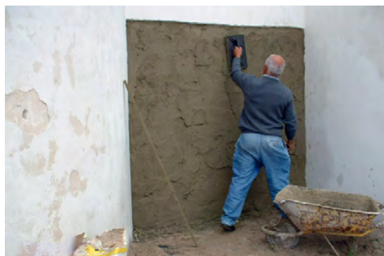
Figura 5 – Testes de argamassas com maior permeabilidade ao vapor de água para resolução de anomalias de revestimentos.
