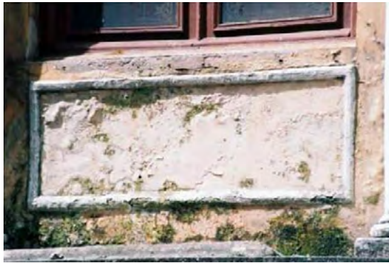
Figura 9 – Arruinamento precoce da fachada de um sobrado, localizado à Rua do Bom Jesus, na cidade do Recife, dois anos após um grande empreendimento de recuperação geral das edificações naquele logradouro histórico. Fon-te: CECI/jul2004
