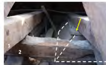
Fig. 5 – Perspectiva do reverso do tecto - visto do telhado. O esquema mostra que a pintura, indicada pela seta, se encontra na horizontal. As linhas a tracejado indicam a estrutura da moldura. Os apoios do telhado e que, por sua vez, também sustentam o tecto, estão assinalados: 1) que representa a estrutura da linha e 2) o tirante.
