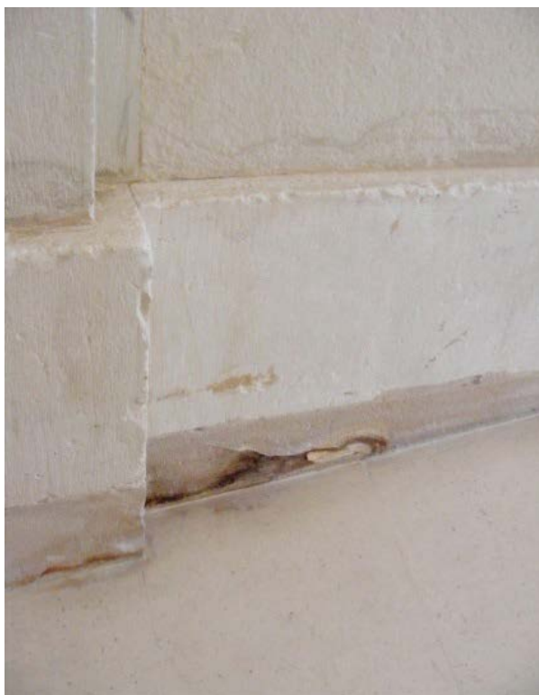
Figura 12 – Pormenor de ascensão capilar da água visível no paramento interior.
