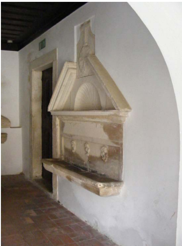
Figura 10 – Aspecto de uma das capelas do Percurso Monumental. Note-se a humidade ascensional na zona junto ao pavimento e na pedra calcária.
