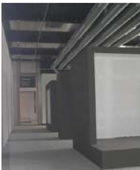
Figura 20 – Palácio Nacional da Ajuda - Conduitas de climatização à vista na Galeria D. Luís I.
