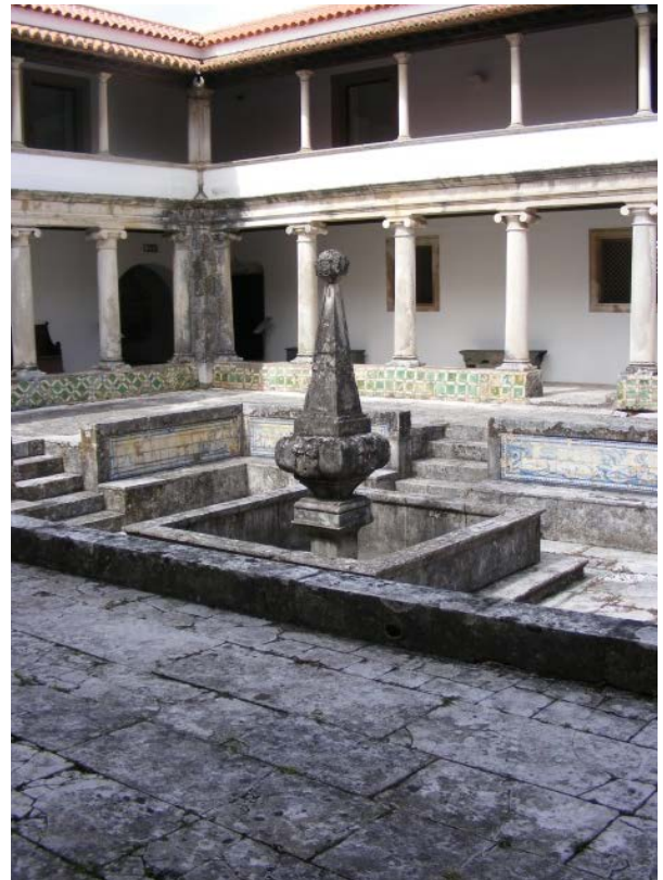
Figura 9 – Aspecto do claustro em pedra e revestido a azulejo (Verão de 2013). É notória a colonização biológica por microorganismos.
