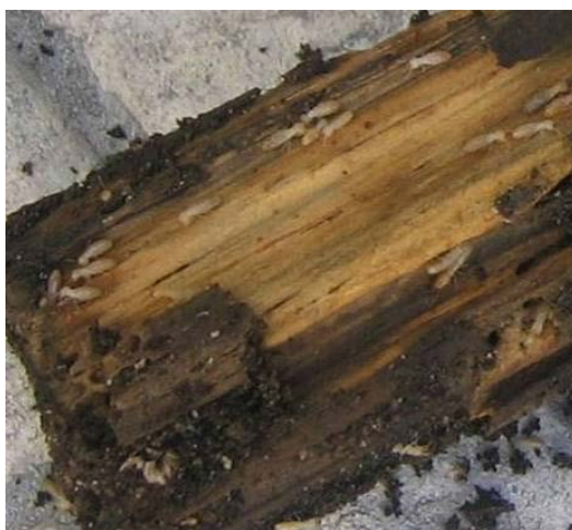
Figura 13 – Pormenor das térmitas vivas em estação de localização de monitorização que se encontrava no solo em torno do AHU.
