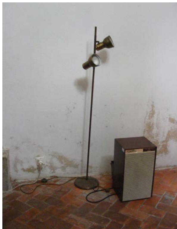
Figura 13 – Pavimento interior de espaço do Percurso Monumental Pavimento cerâmico e parede com eflorescências salinas.
