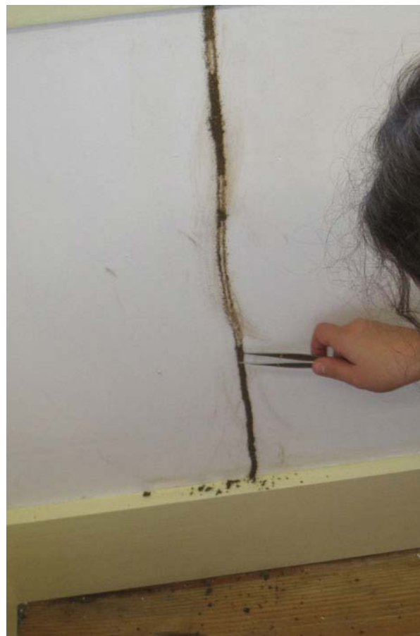
Figura 9 – Canal de comunicação de térmitas em depósito.
