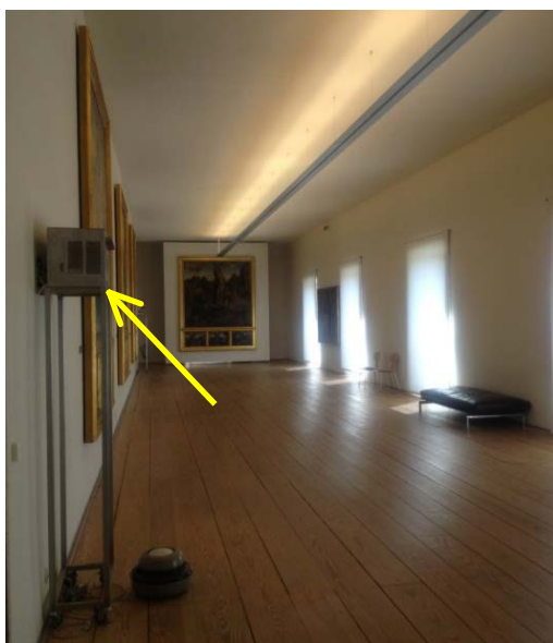
Figura 25 – Aparelho humidificador colocado para compensar os efeitos do pavimento radiante. 14
