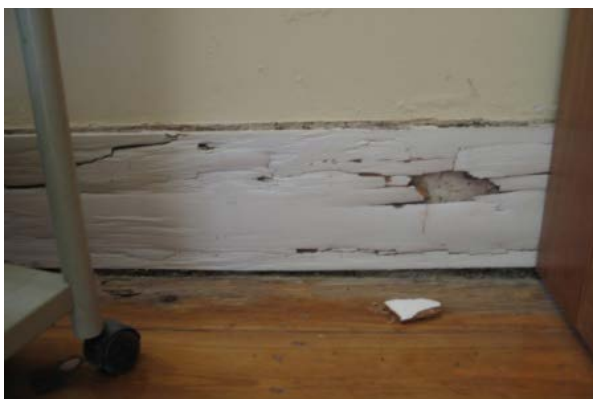
Figura 8 – Rodapé com lacunas no interior da madeira.
