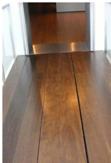
Figura 18 - Passadiço suspenso no 2º piso. Ligaç o da Casa do cabido  s edifica es anexas. Guardas de protec  o lateral com 1m e altura n o cumprindo legisla  o em vigor.
