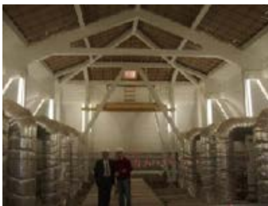
Figura 21 – Museu Nacional de Arte Antiga - Conduitas de climatização no desvão da cobertura.
