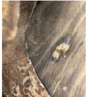
Figura 47- Elementos metálicos oxidados
