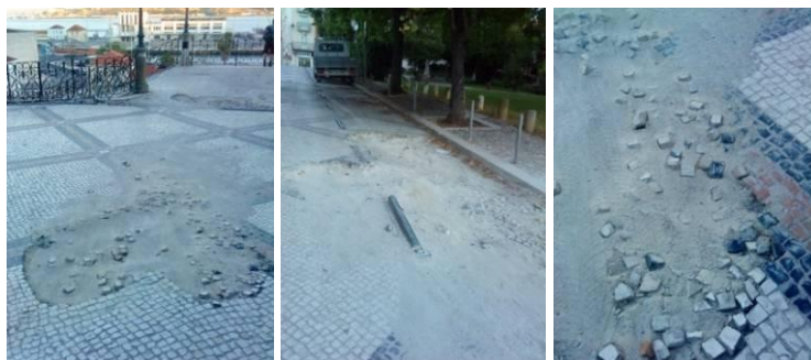
FIGURA 73 - DEGRADAÇÃO DO PAVIMENTO EM CALÇADA JARDIM 9 DE ABRIL - MUSEU NACIONAL DE ARTE ANTIGA FOTOS DA AUTORA
