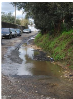
FIGURA 132- DEGRADAÇÃO DO PAVIMENTO
