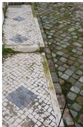
CALÇADA A RECUPERAR
