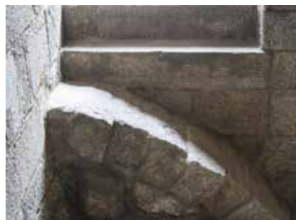
Fig. 49 – Absorção defeituosa da abóbada da nave colateral sul, pela torre meridional.
