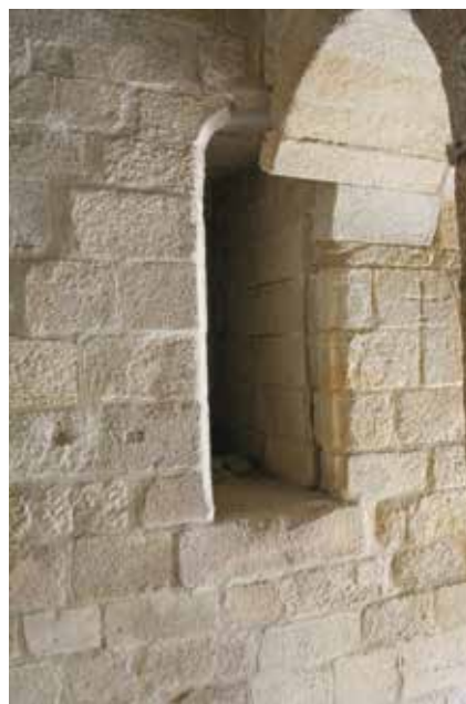
Fig. 50 – Antiga passagem de acesso da torre sul ao dorso exterior da abobada da nave central.
