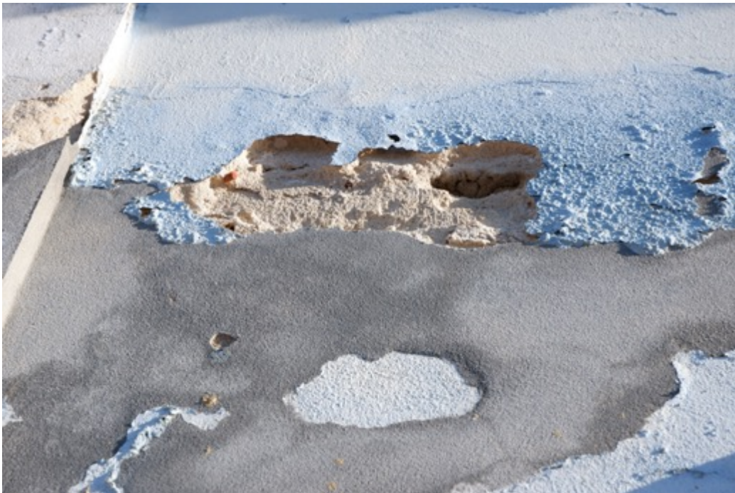
Pano de fachada. Observa-se a perda de aderência de camadas de argamassa e da camada de pintura e a presença de argamassa de cimento.
