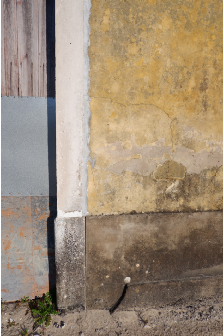
Pormenor de cantaria do portão e lambril com superfície deteriorada pela biodeterioração, com fungos e biofilmes. O pano de fachada apresenta alterações cromáticas, manchas de humidade e fissuras.
