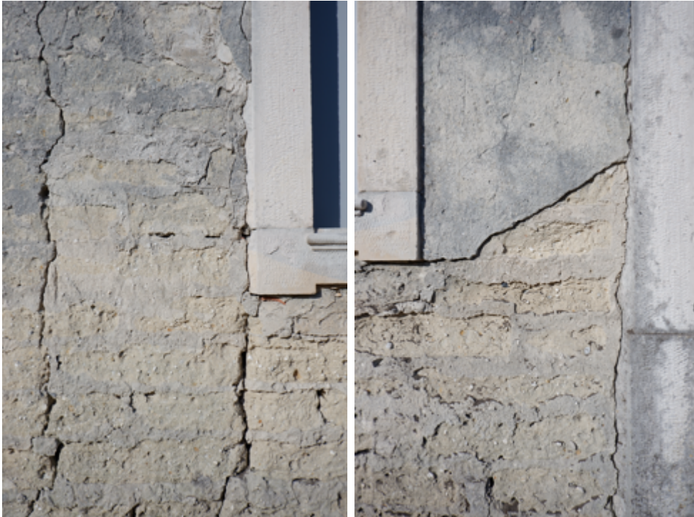
Pano de fundo com lacuna, perda de aderência das camadas de argamassa.
