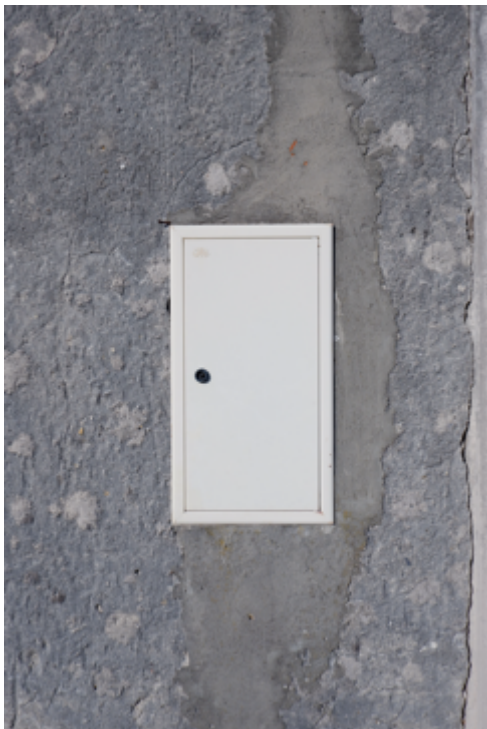
Pano de fundo com presença de argamassa de cimento.
