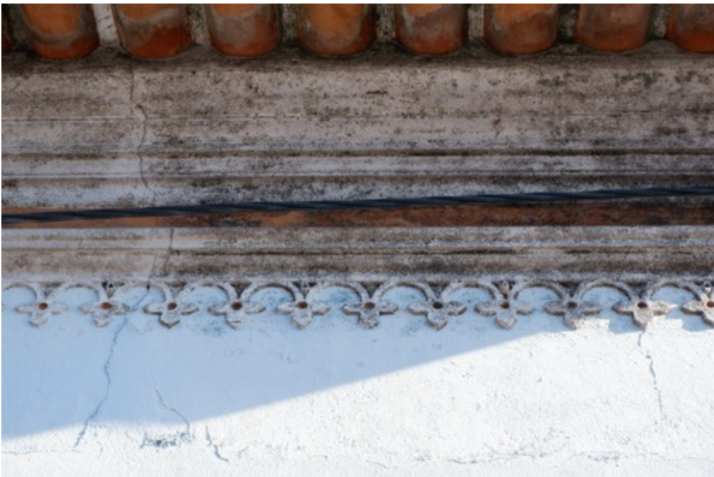
Pilastra com manchas de humidade. Friso pintado e elementos decorativos com fissuras e manchas de humidade.
