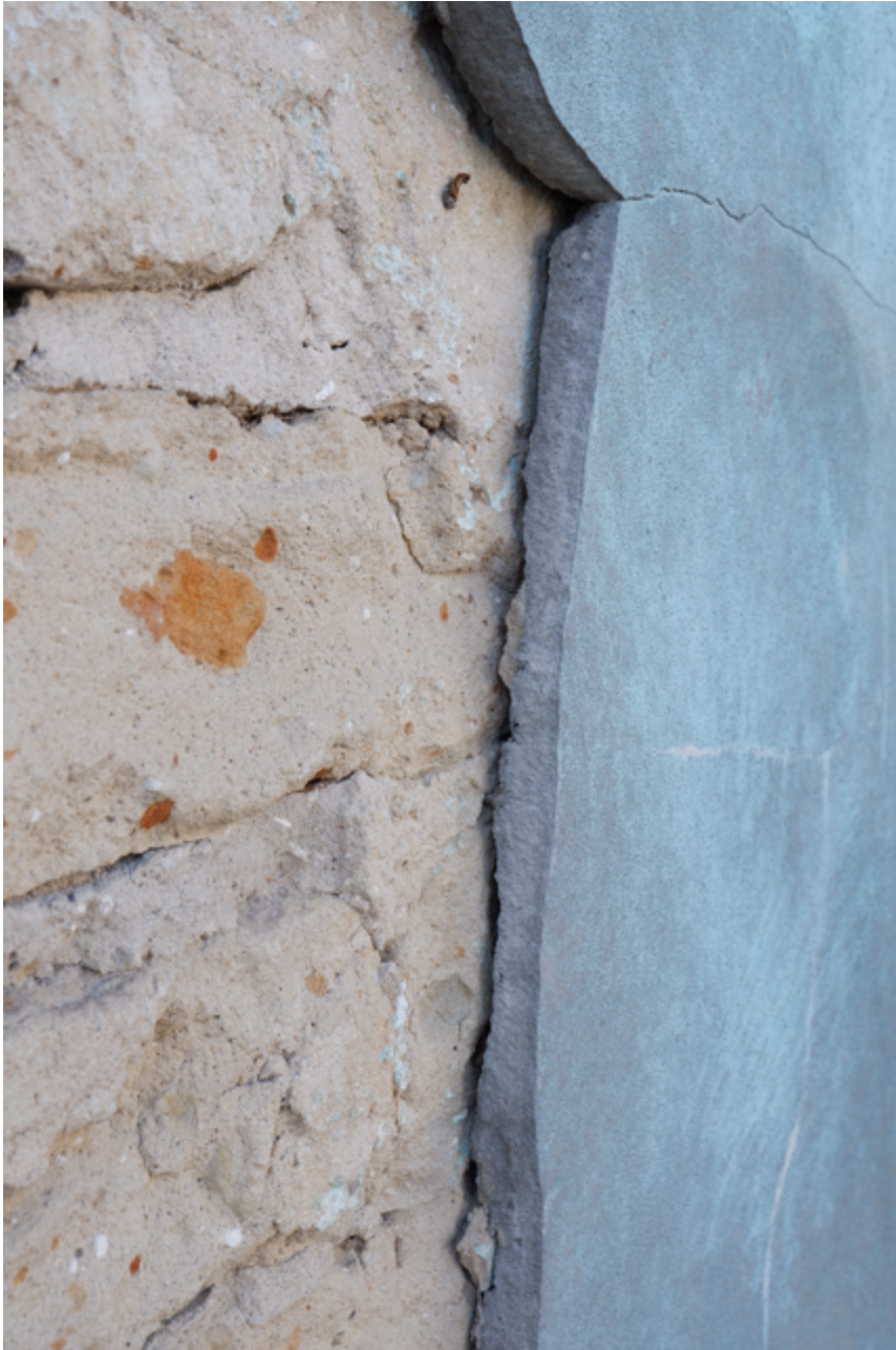
Pormenor pano de fachada com perda de aderência da camada de acabamento.
