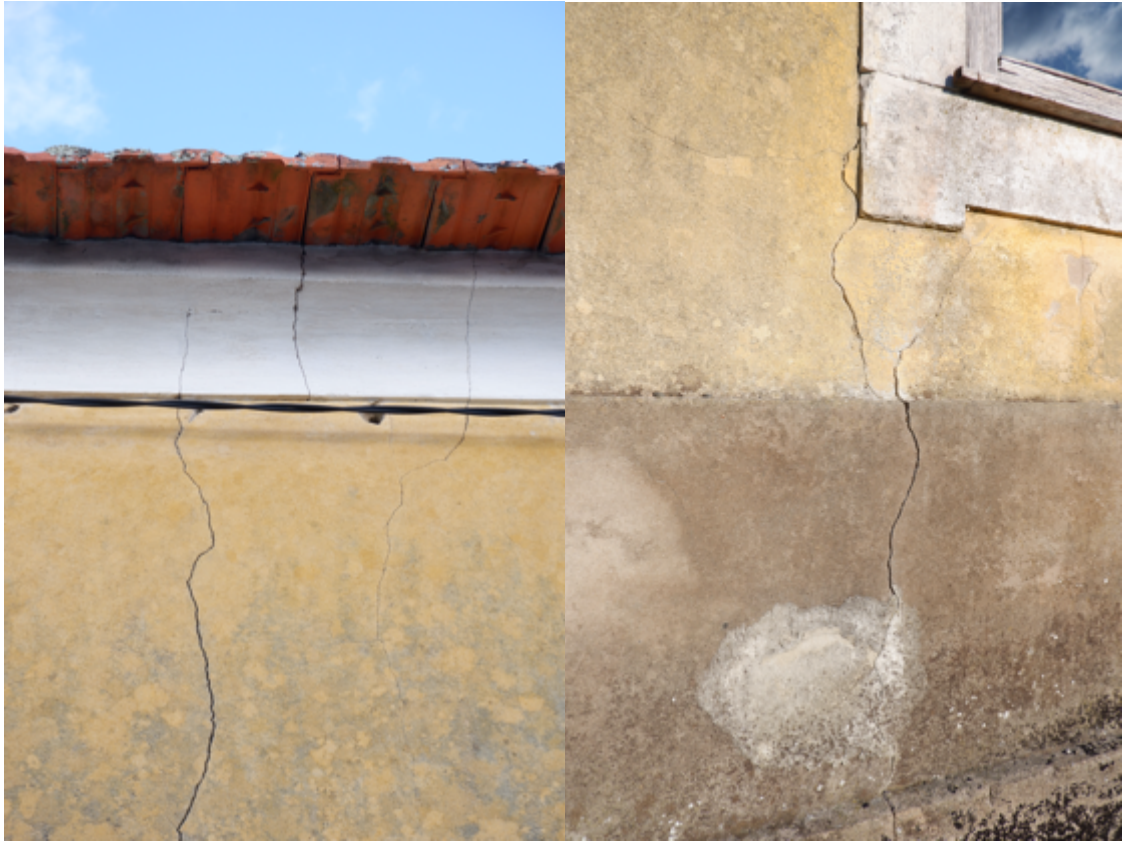
Cimalha/cornija com fissuras e fendas.
