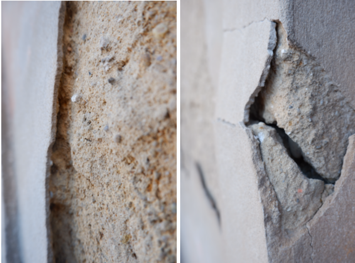
Presença de perda de aderência das camadas de acabamento em pormenor de pano de fachada. Pormenor cunhal com perda de aderência das camadas de acabamento.
