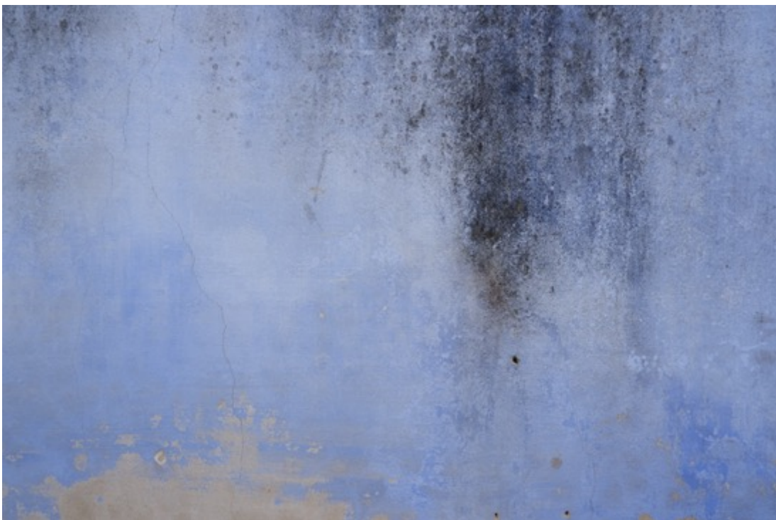
Parede interior em estado degradado e em ruína Pano de fachada com perda de coesão da camada de pintura e manchas de humidade
