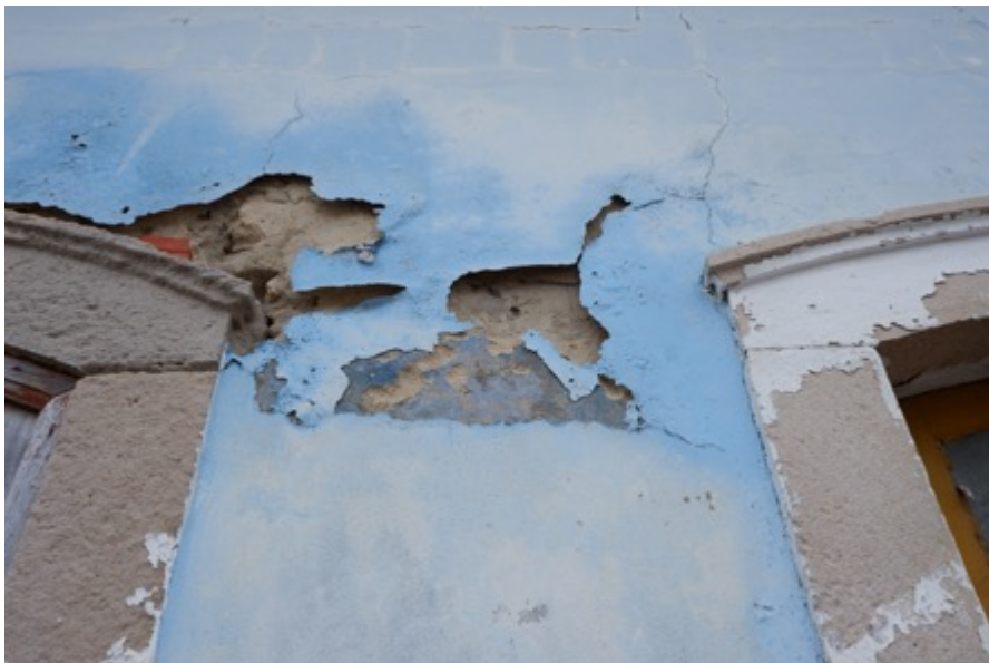
Pano de fachada. É observável a perda de aderência de camadas de argamassa e da camada de pintura, bem como alterações cromáticas desta.
