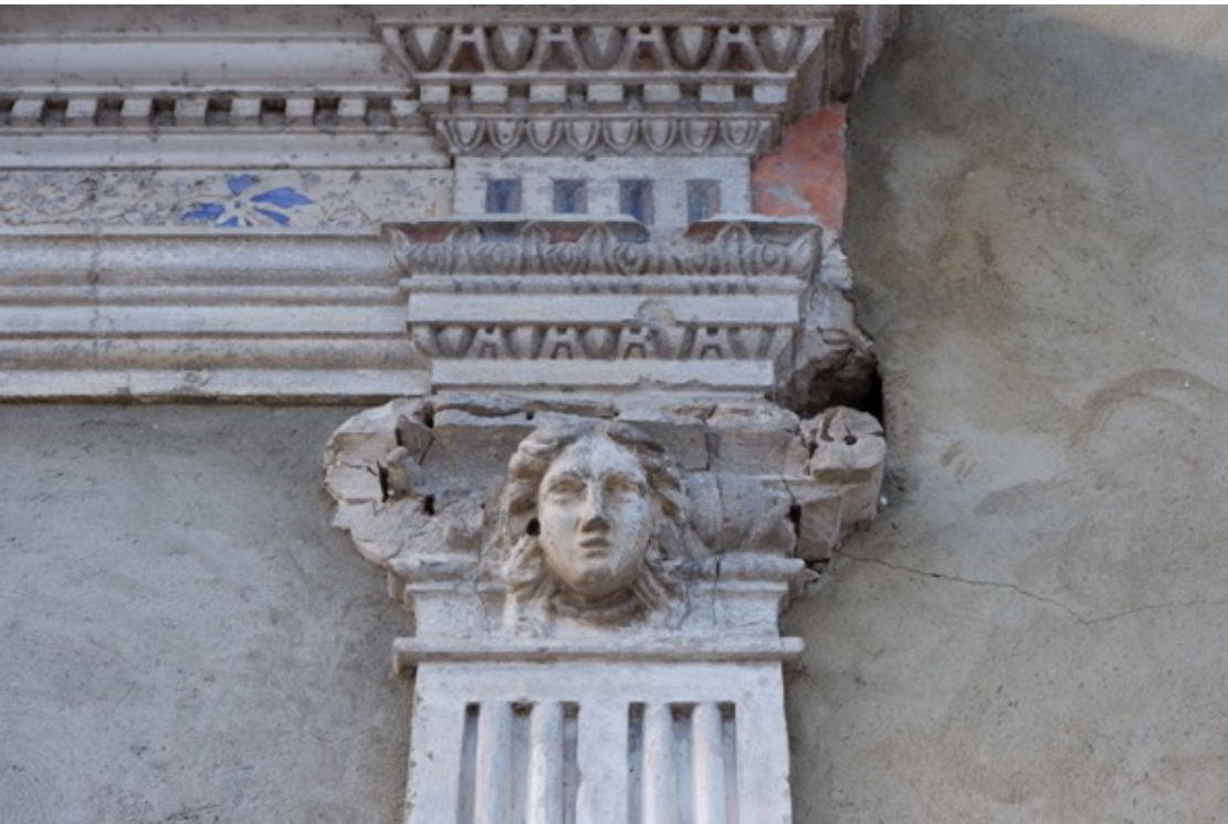
Pilastra com cara em estado de degradação , perda de aderência de reboco do elemento decorativo. Observa-se um fragmento de pintura de cor vermelha.
