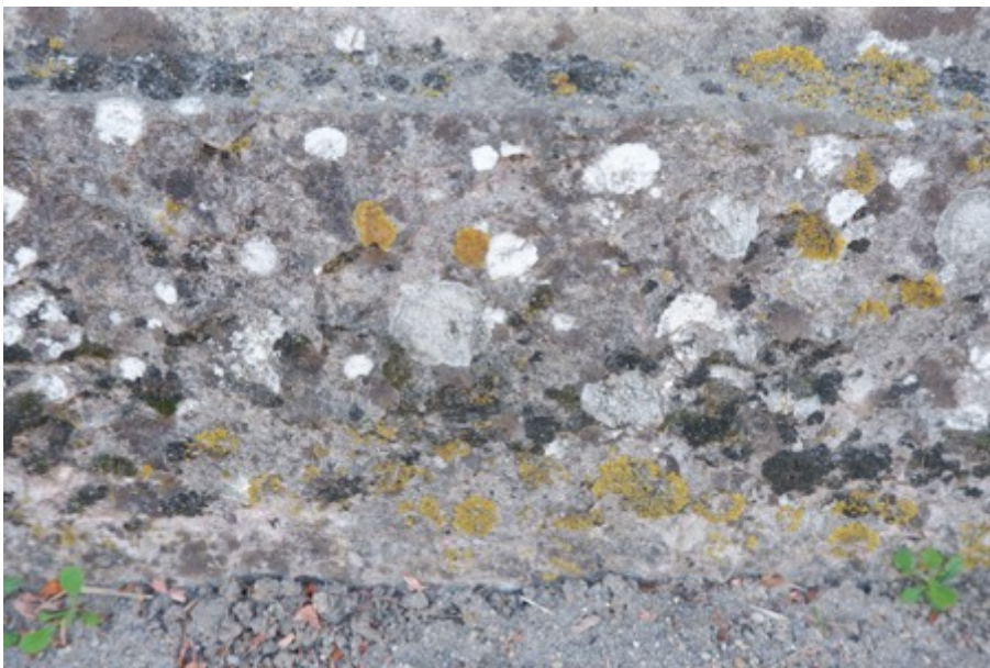
Pormenor de lambril que apresenta a superfície deteriorada pela biodeterioração, com fungos e biofilmes.
