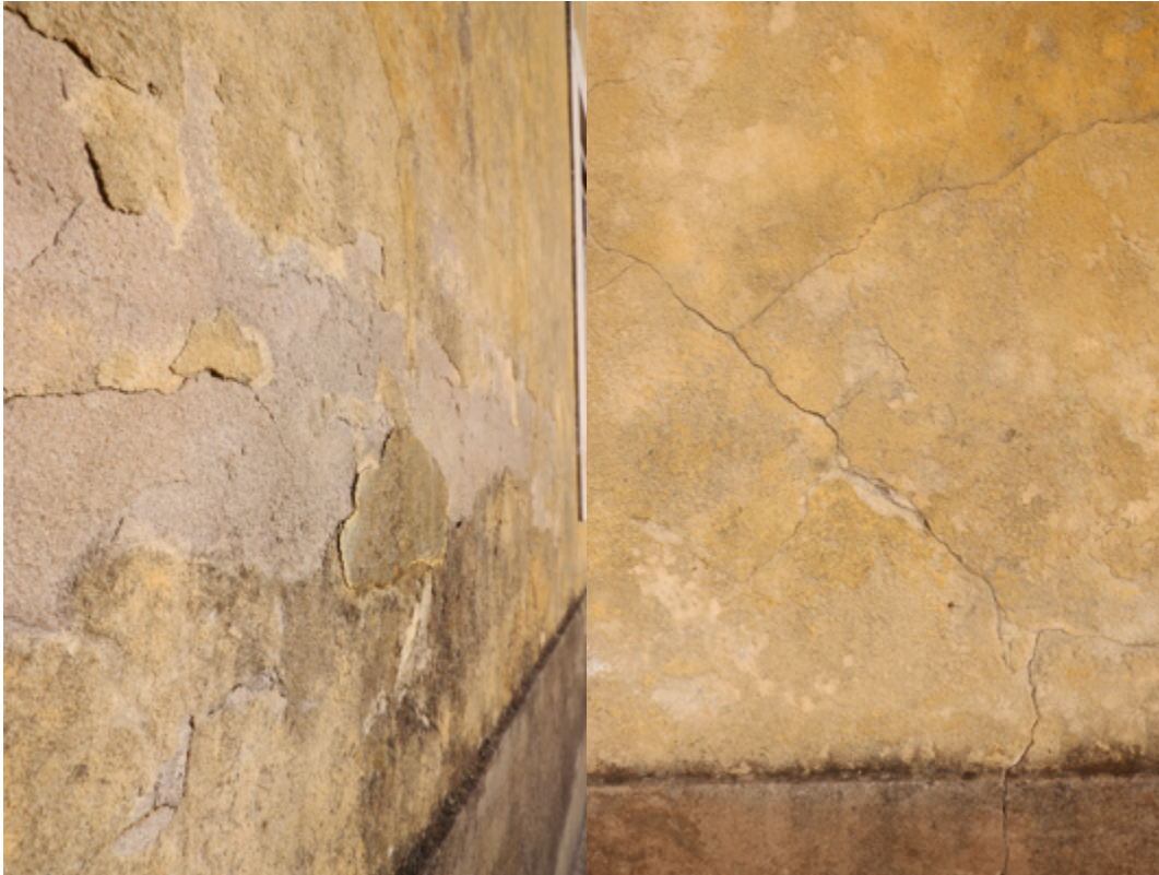
Pano de fachada com perda de coesão da camada de pintura e presença de fissuras.
