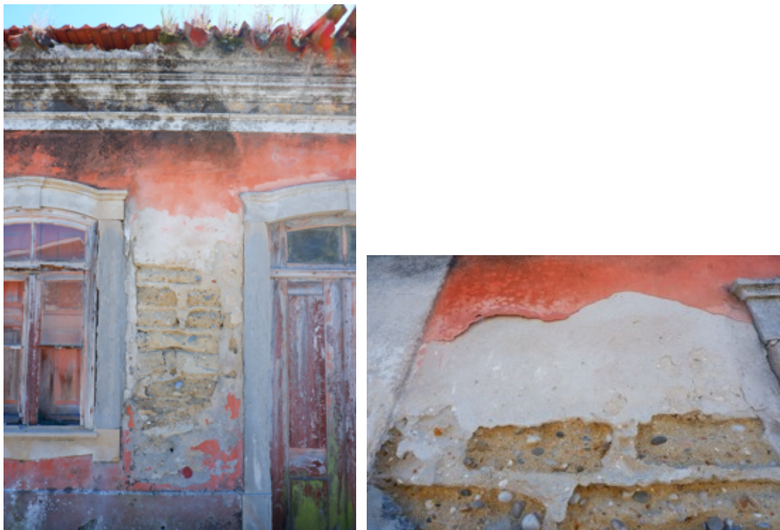
Pano de fachada onde se identifica a presença de argamassa de cimento e manchas de humidade, falta de aderência das camadas de argamassa e falta de coesão da camada de pintura.
