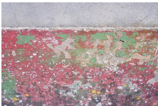
Figura 50 Biodeterioração em revestimento. Calvão ©Inês Barreira
