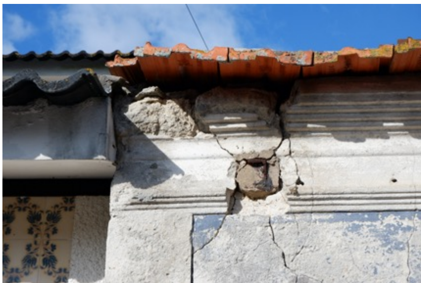
Cimalha/cornija com lacuna, perda de aderência da argamassa e fendas.
