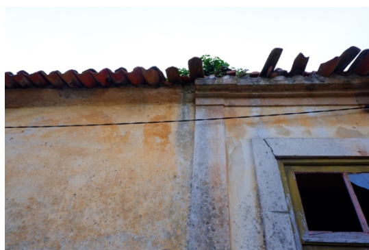
Figura 48 Humidade e perda de coesão em revestimento. Calvão ©Inês Barreira
