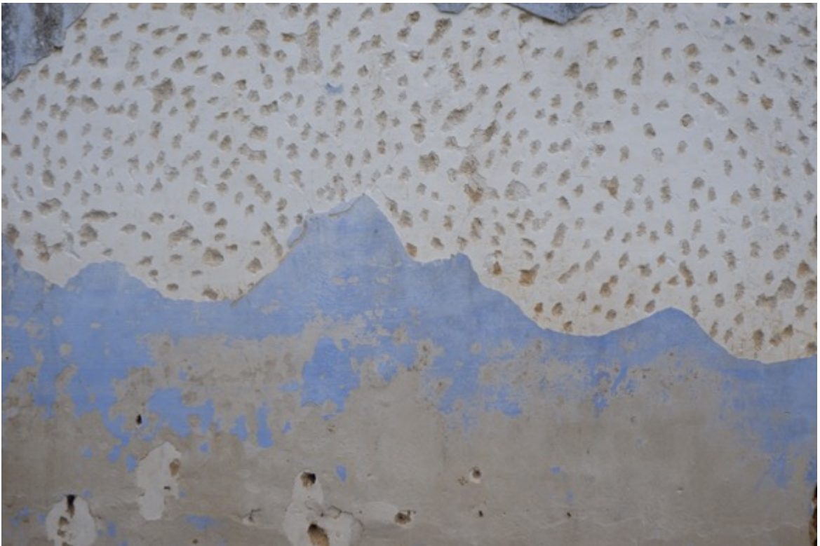
Pano de fachada com perda de aderência das camadas de argamassa e de pintura e perda de coesão da camada de pintura
