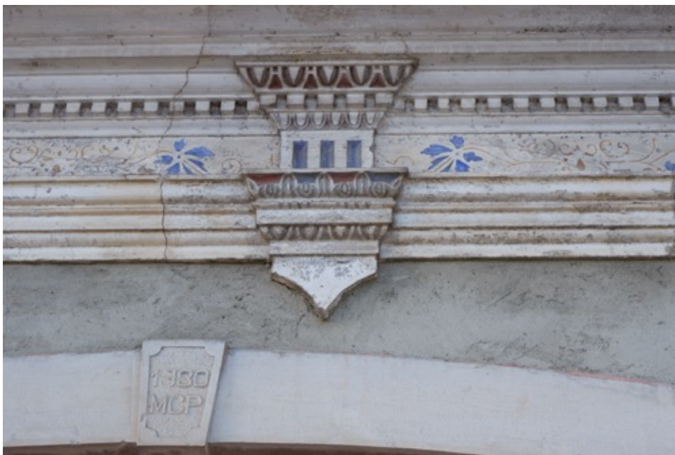
Friso pintado, elemento decorativo e Era. Observa-se a perda de aderência de grande parte do elemento decorativo. São visíveis manchas de humidade e fissuras no reboco decorativo.
