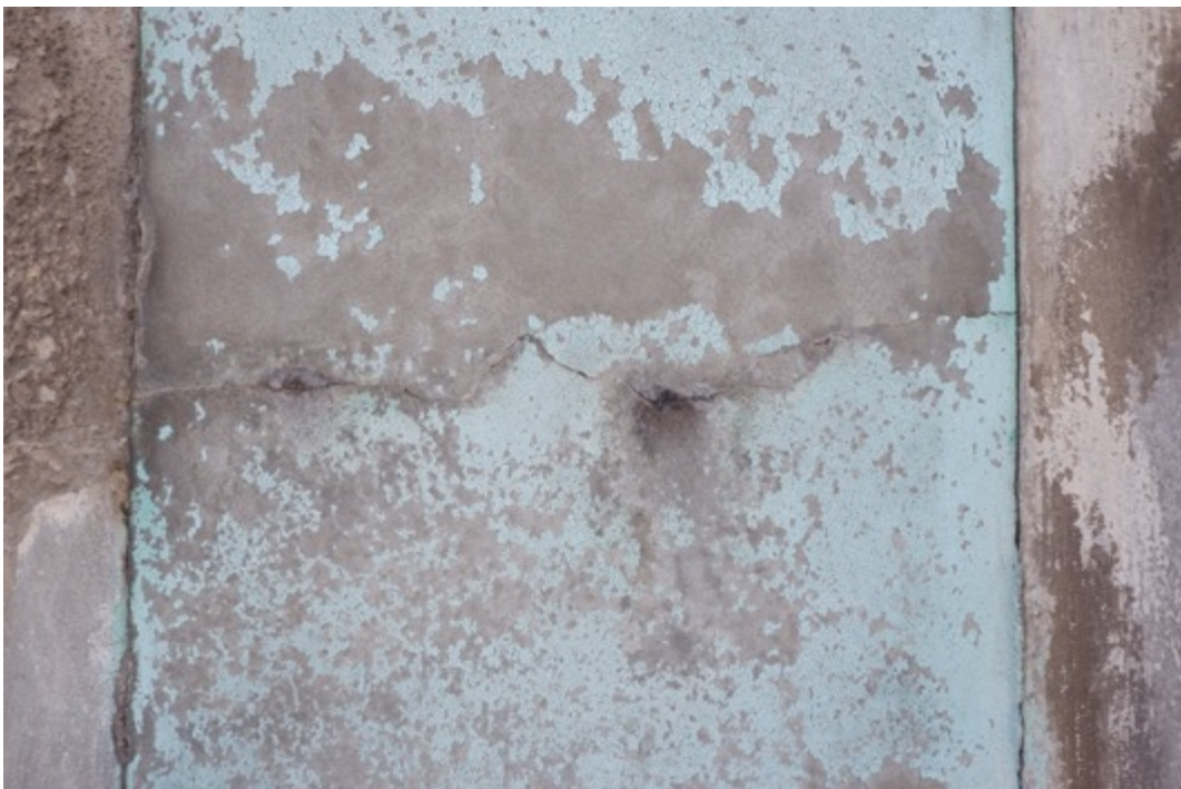
Cantaria com fissuras e perda de coesão da camada de pintura Pano de fachada onde se observa a perda de coesão da camada de pintura e fissuras
