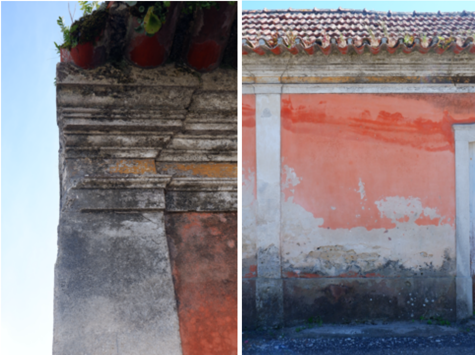
Cunhal e friso pintado com manchas escuras de humidade.
