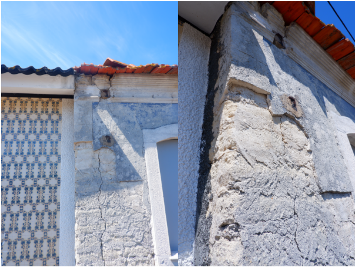
Cunhal e pano de fachada com lacuna significativa provocada pela perda de aderência de camadas de argamassa. Verifica-se, ainda, a alteração cromática no pano de fachada.
