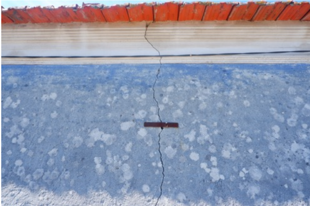
Pano de fachada com fenda e perda de coesão da camada de pintura, apresentando, ainda, a superfície deteriorada pela biodeterioração, com fungos e biofilmes.
