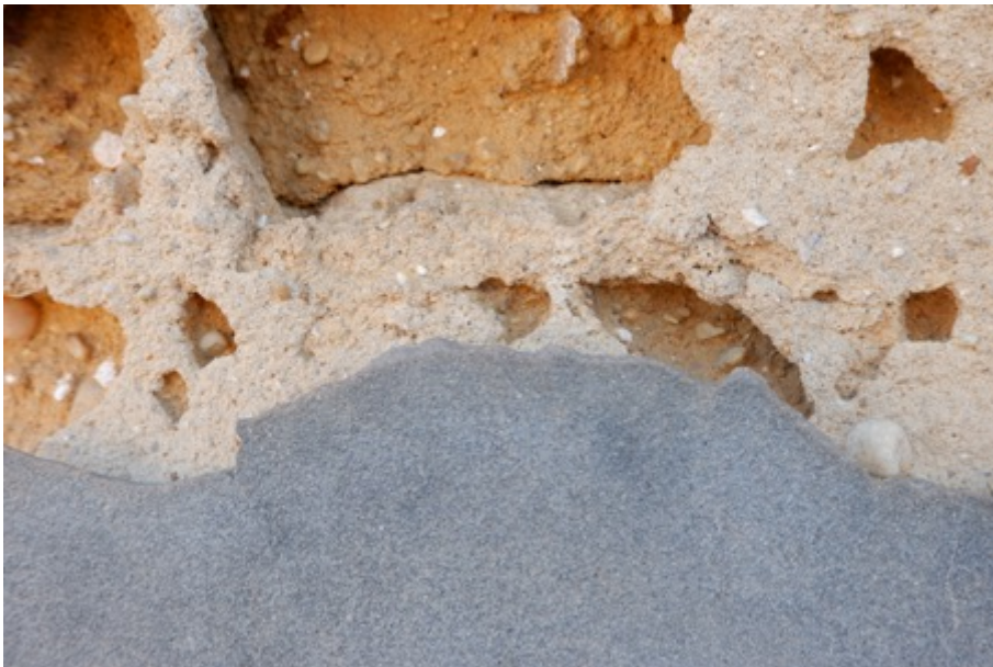
Neste pormenor pano de fachada observa-se a perda de aderência das camadas de argamassa e a presença de argamassa cimentícia.
