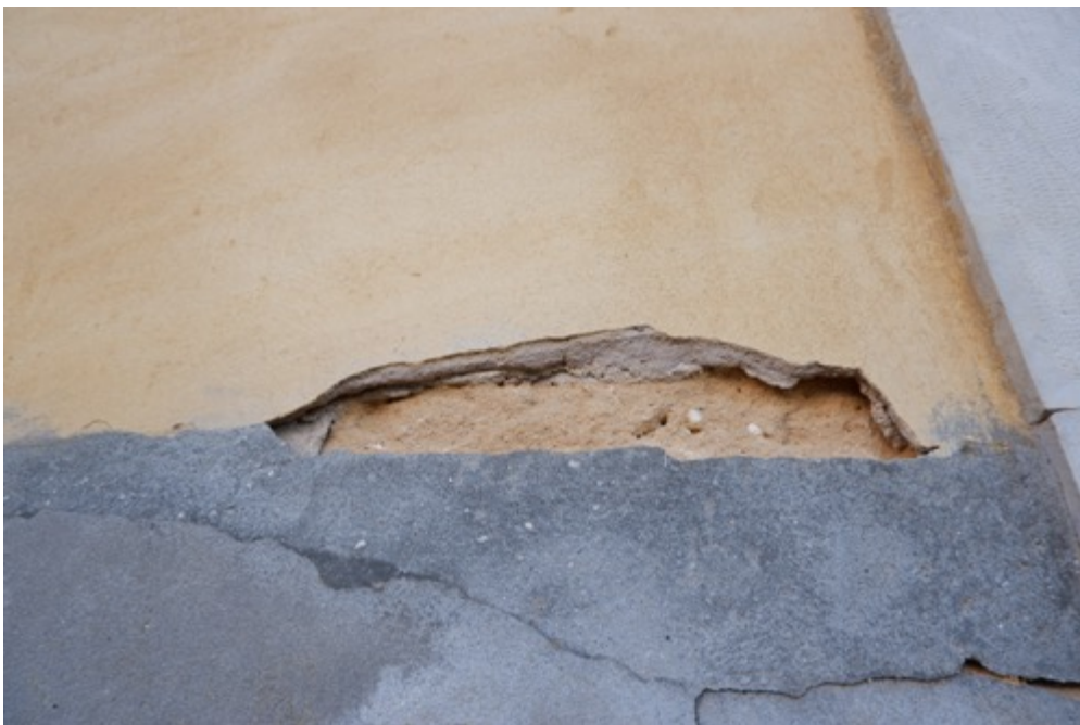
Pano de fachada com perda de aderência das camadas de acabamento. Este pano de fachada apresenta perda de aderência das camadas de acabamento, resultando numa lacuna e aplicação de argamassa de cimento.
