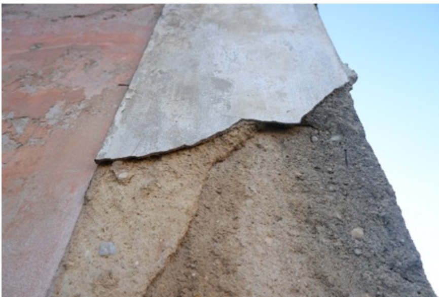
Pano de fachada e cunhal com perda de coesão da camada de pintura. Pormenor cunhal , onde se observa a presença da perda de aderência das camadas de argamassa e camada de pintura. A mancha escura observada na camada de argamassa poderá estar associada a danos provocados pela humidade.
