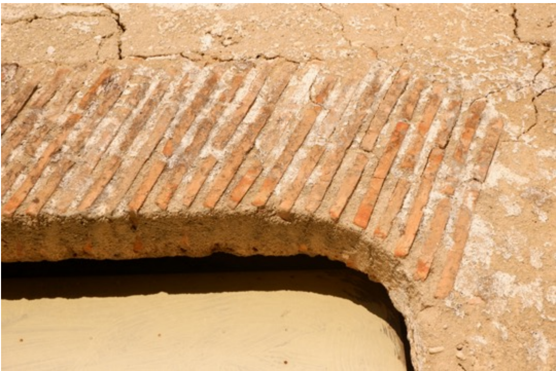
Pormenor de tijolos com função estrutural dos vãos. Observa-se, em toda a fachada, a perda de aderência das camadas de acabamento, fissuras e fendas
