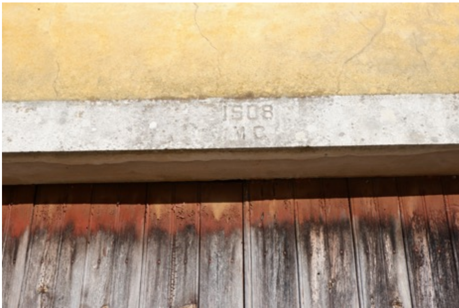
Pormenor cantaria do portão com data da construção e iniciais do primeiro proprietário. Pano de fachada e cunhal com alterações cromáticas, manchas de humidade e argamassa de cimento.
