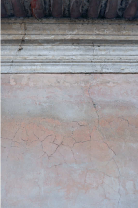
No pano de fachada observa-se a perda de coesão da camada de pintura, a presença de fissuras e alteração cromática. Na cimalha/cornija identificam-se fissuras e alteração cromática.
