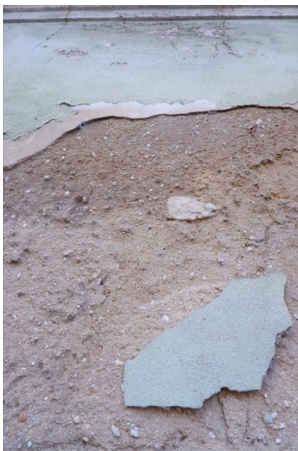
Figura 49 Perda de coesão e aderência em revestimento e cantarias feitas em cal. Rua da Igreja Calvão ©Inês Barreira
