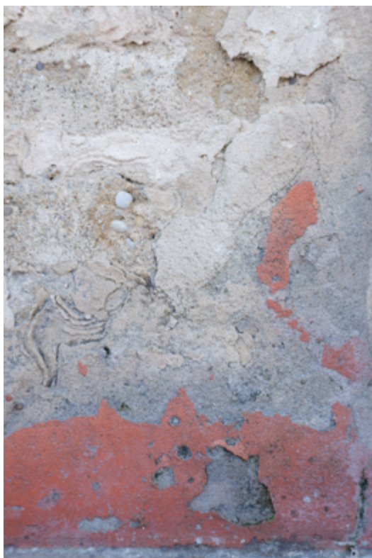
Pano de fachada com manchas de humidade e perda de aderência das camadas de argamassa e de pintura. Verifica-se o desgaste do revestimento que resulta da acção erosiva.
