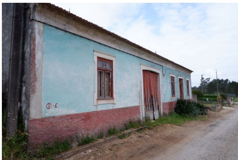
Figura 26 Cor base: azul; Cores complementares do conjunto: vermelho (embasamento) e branco (cantarias, cunhais e cornija/cimalha) Rua das Quinas, Santa Catarina e Ponte de Vagos ©Inês Barreira
