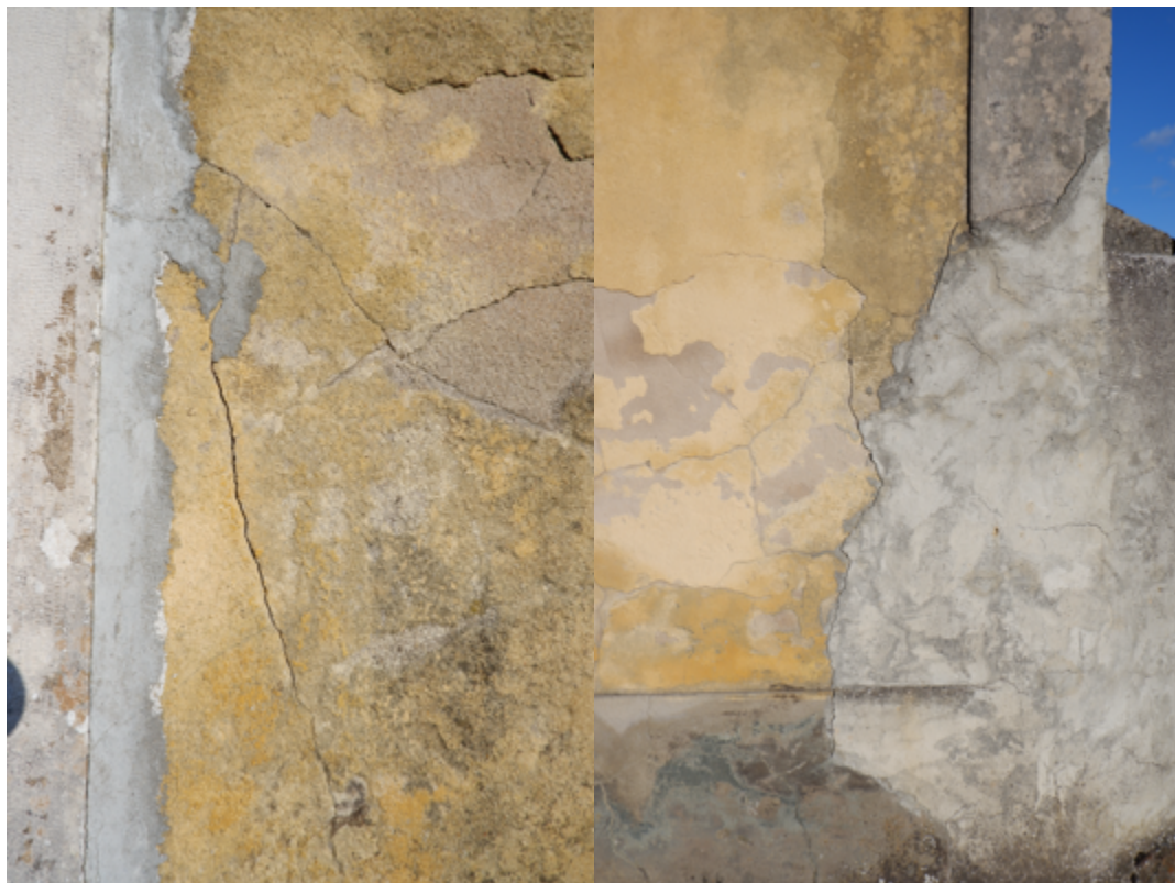
Pano de fachada e cunhal. Identificam-se manchas de humidade e alterações cromáticas. É possível verificar a presença de fissuras e fendas. É, ainda, observável a presença de argamassas de cimento.
