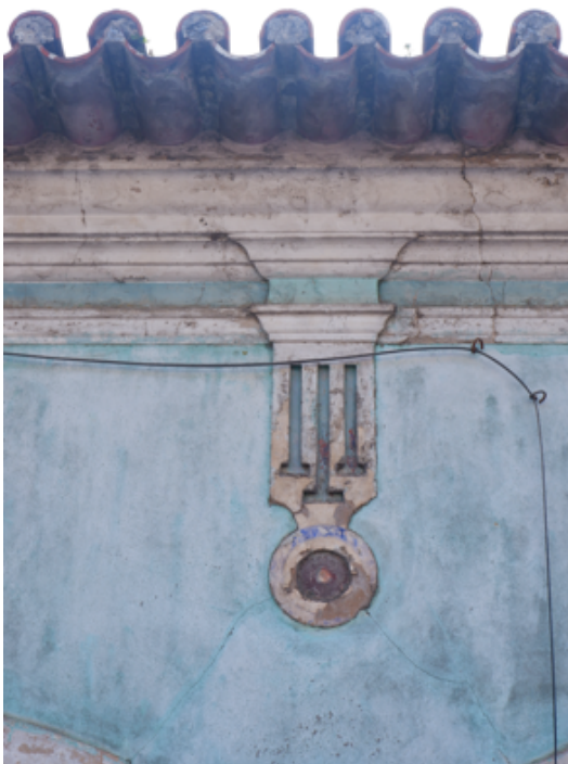
Cornija/cimalha e elemento decorativo. É possível observar a presença de fissuras na cornija/cimalha e perda de coesão da camada de pintura do elemento decorativo.
