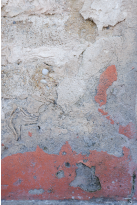
Pano de fachada com manchas de humidade e perda de aderência das camadas de argamassa e de pintura. Verifica-se o desgaste do revestimento que resulta da acção erosiva.
