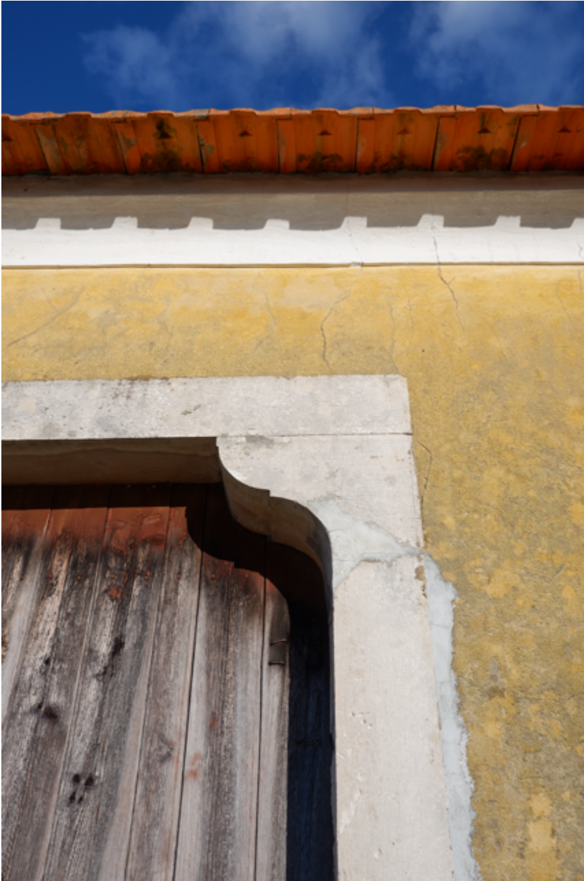
Pormenor da cantaria do portão com manchas de humidade e argamassa de cimento.
