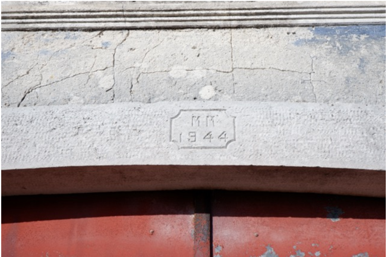
Pormenor da Era com iniciais e data de construção. No pano de fachada observam-se fissuras e perda de coesão
