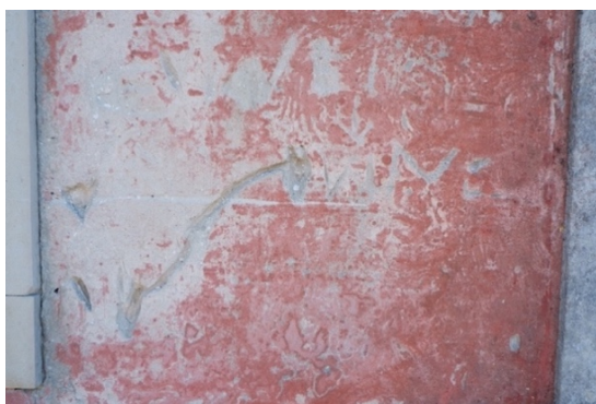
Figura 52 Erosão em revestimento. Rua da Cabine, Calvão ©Inês Barreira
