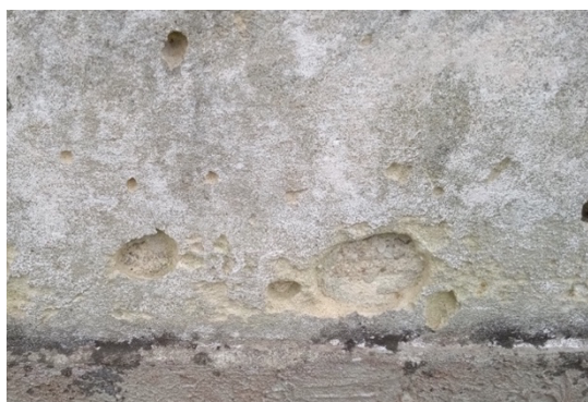
Figura 51 Biodeterioração em revestimento. Nacional 109, Calvão ©Inês Barreira
