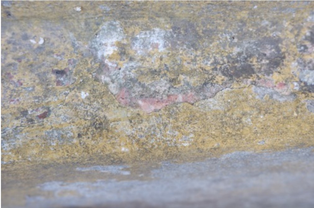
Pormenor de lambril que apresenta a superfície deteriorada pela biodeterioração, com fungos e biofilmes. É possível verificar, também, mais do que uma camada de pintura.
