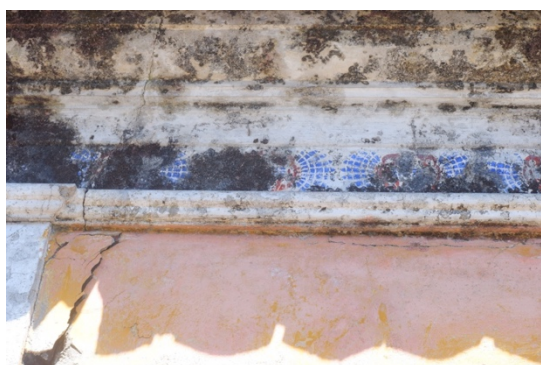
Figura 47 Humidade, perda de aderência, fissuras e alterações cromáticas em revestimento. Travessa da Parada, Sosa ©Inês Barreira
